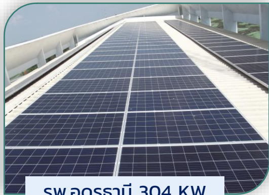
sw.อุดรธานี 304 KW
